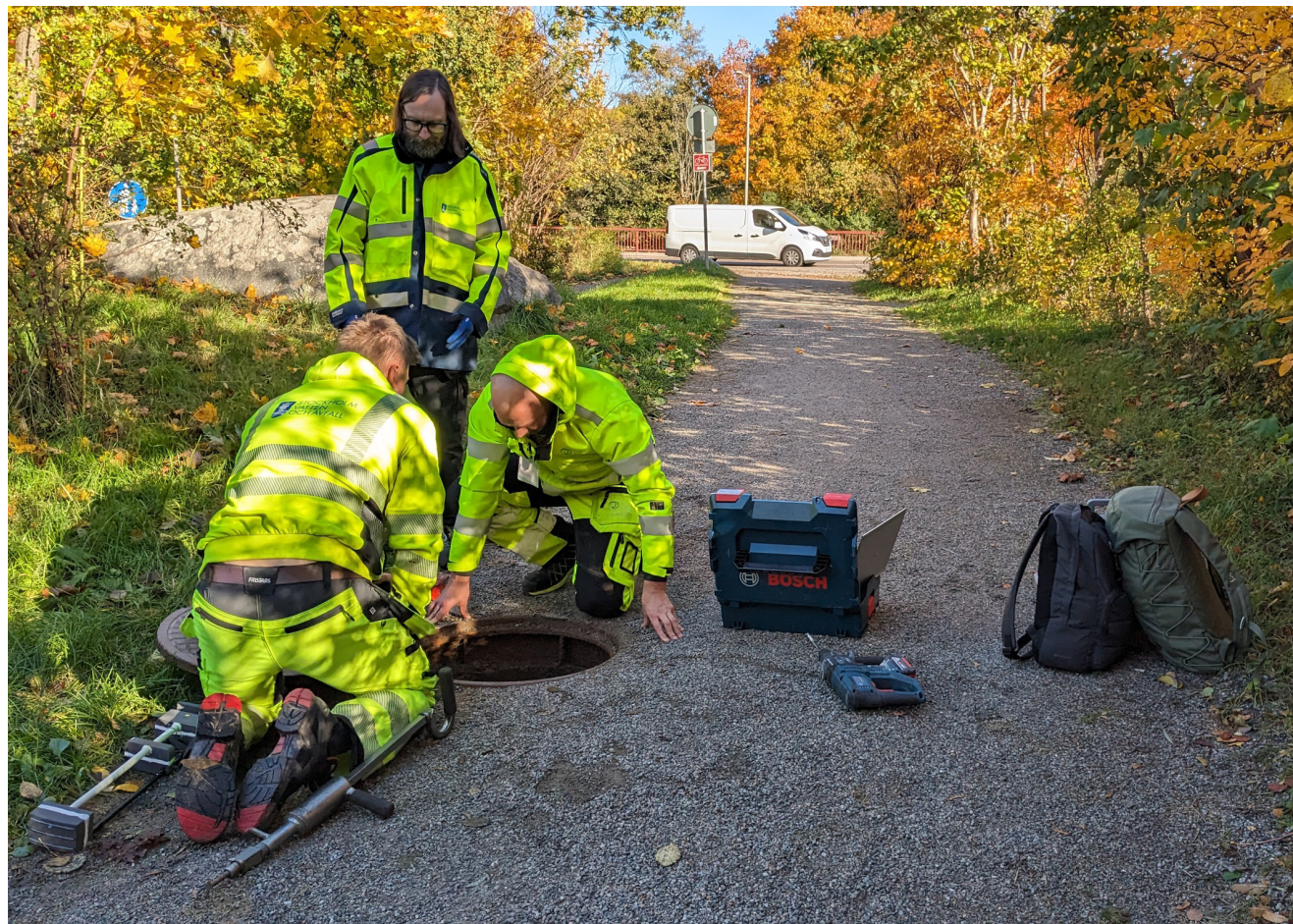
Carl Jonsson och Björn Karlsson från Stockholm Vatten och Avfall samt Jacob André från IVL Svenska Miljöinstitutet installerar Turbinatorn i Stockholm.
