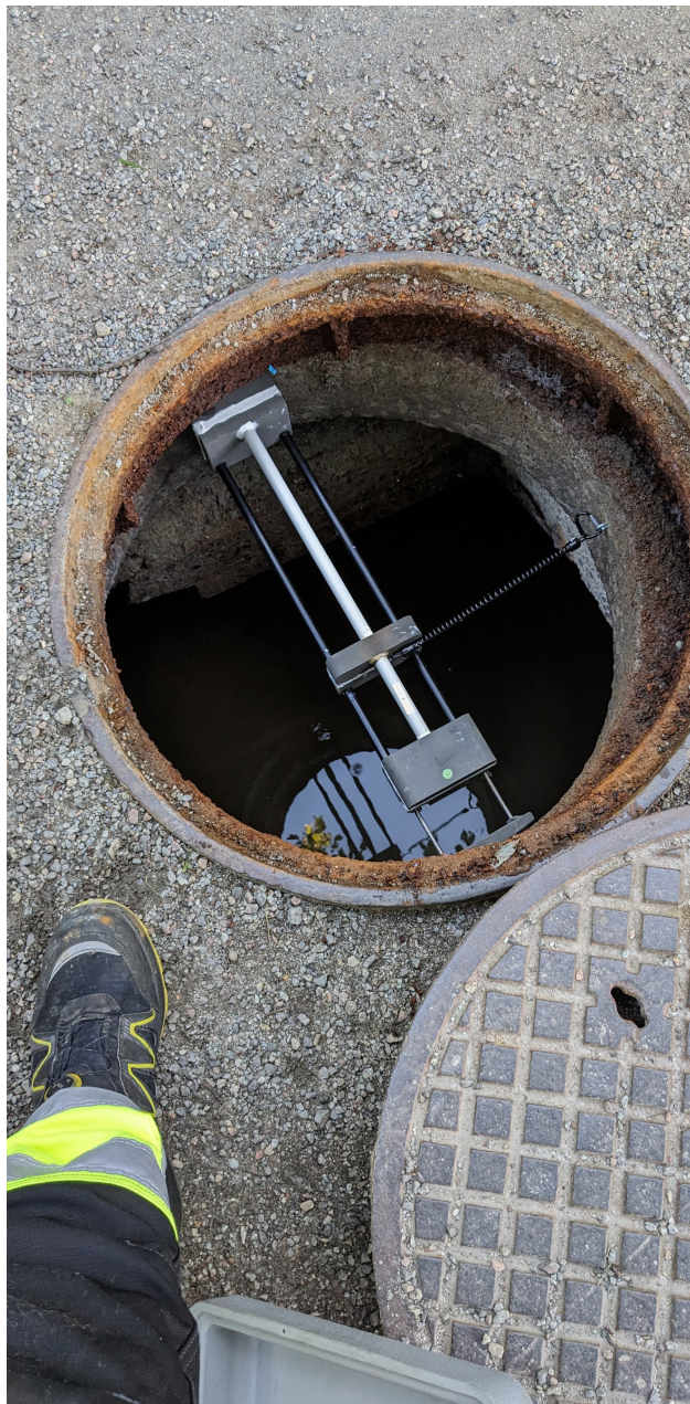
Turbinatorn på plats i en brunn.
