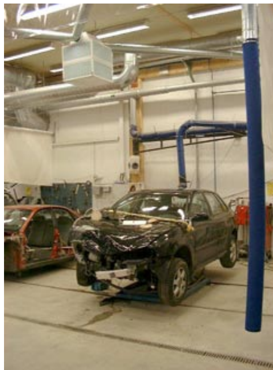
Bild 13. Tilluft genom strumpa av textil, som ses till höger på bilden. Eftersom ytan är stor blir hastigheten på den tillförda luften låg, vilket minskar risken för drag. Här var luften för varm och steg uppåt längs strumpan istället för att tillföra tilluft till arbetsplatsen intill strumpan.
