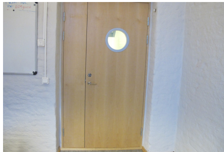
4. Dörrpartier, vilket inkluderar brand-dörrar, ståldörrar, entrépartier samt innedörrar både i trä och glas.
