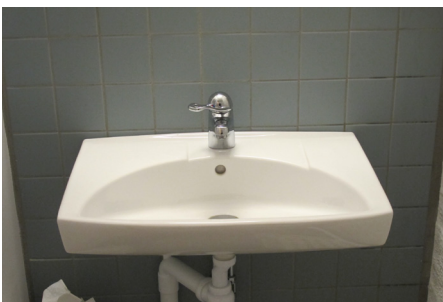
5. VVS såsom WC stolar, tvättställ, blandare och utslagsbackar.
