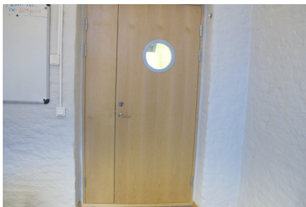
4. Dörrpartier, vilket inkluderar brand-dörrar, ståldörrar, entrépartier samt inredörrar både i trä och glas.
