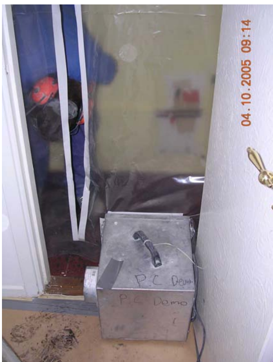
Bild 2. En bra avskärmning med luftrenare. Den luftrenare som syns på bilden är vanlig på byggarbetsplatser idag. Vi rekommenderar dock en luftrenare med högre flöde än den som visas på bilden. Luftrenare kan normalt sett inte förväntas hålla dammhalterna innanför inkapslingen under gränsvärdet. Däremot kan flödet räcka för att hålla undertryck innanför plasten. Undertrycket förhindrar att damm läcker ut ur inkapslingen och sprids till angränsande lokaler.
