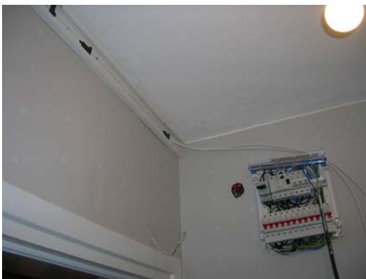
Bild 9a och 9b Elledningar som dras i utanpåliggande lådor (kanaler).
