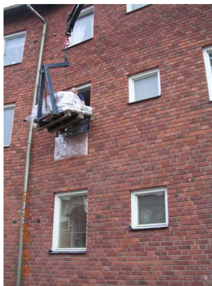
Bild 31. Lyfter in säckar med leca-kulor och marmorkross genom fönstret, säckarna väger ca 25 kg styck. Ingen säkerhetssele användes.
