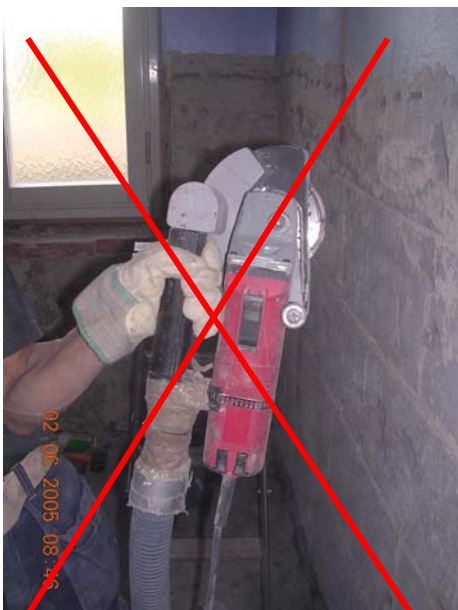
Bild 13. Dålig lösning, använd riktiga kopplingar mellan verktyg och industridammsugare.
