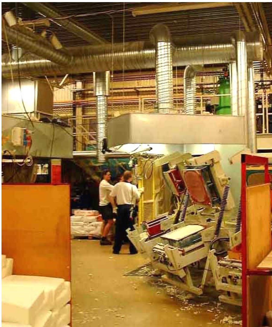
Bild 5 Specialventilation över formarna
