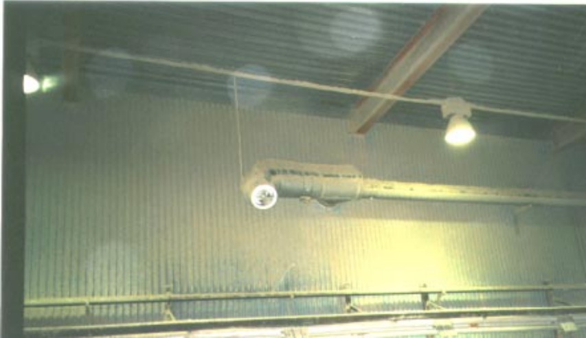
Bild 4. Mottagningshall till Katrineholm Energi
