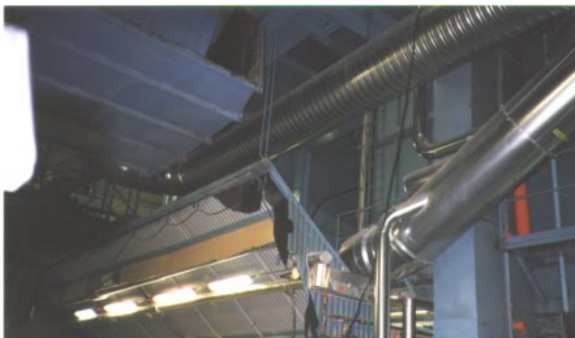
Bild 2. Ventilation i mottagningsfickan
